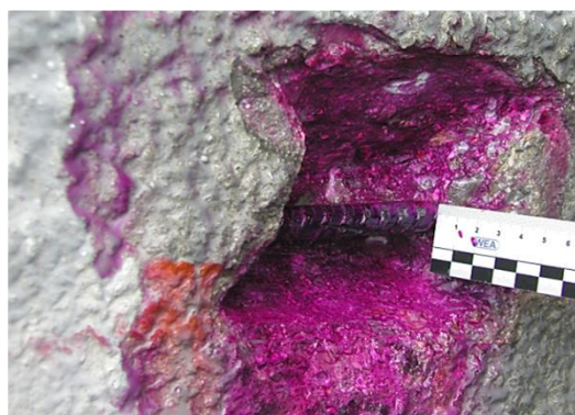
Fig. 8. Ensayo de carbonatación en una de las columnas de la estructura. Se observa la coloración violeta en toda la zona del hormigón y el estado de pasivación en el acero de refuerzo.
